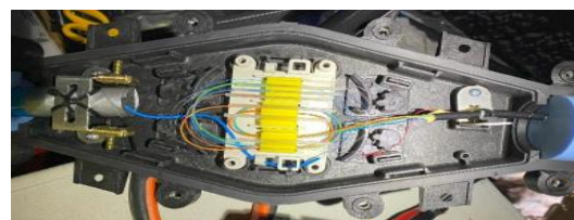
COYOTE LCC Enclosure (No.13) 60°HWCとLinear Cable の接続
